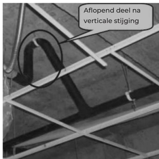
Aflopend deel van afvoerleiding
