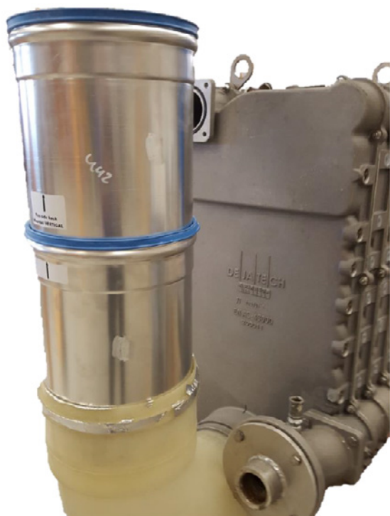
Twee dempers gemonteerd op een 5-delige ketel (340 kW)
